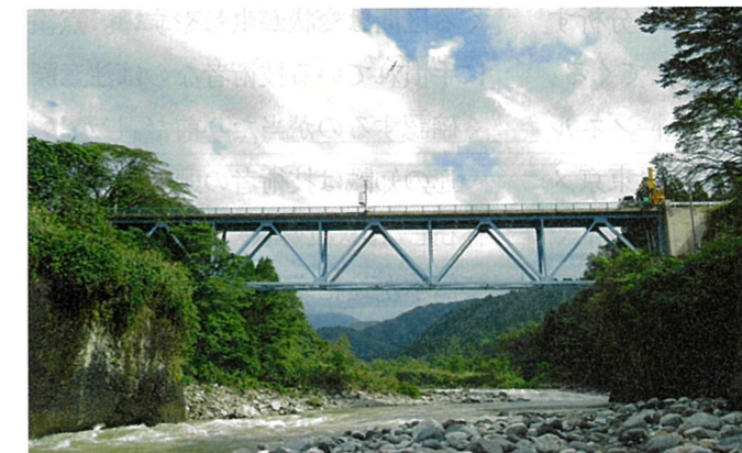
写真4 ■ 富山市郊外にあり、既に通行止めとなっている瓶岩橋。付近に採石場があり、植野氏は通行車両の過積載による損傷を疑っている
