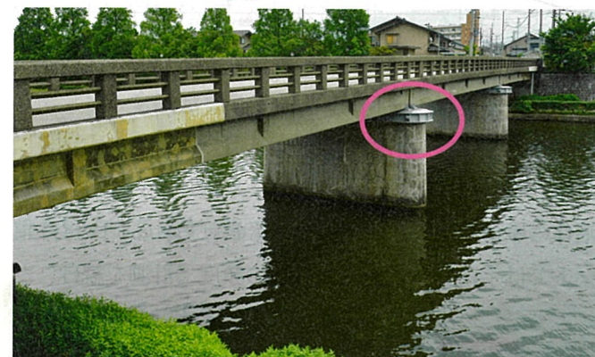
写真1 ■ 富岩運河に架かる下新橋。右岸側の橋脚の上部(赤線内)にひび割れが生じた。写真は補修後に撮影(写真:本誌)
