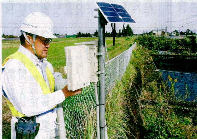
センサーの信号を受け取る制御ボックスを点検する松谷さん(富山市内)
